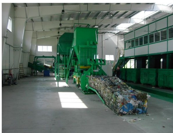
Fot 2. 4. Linia technologiczna segregacji mechanicznej odpadów
